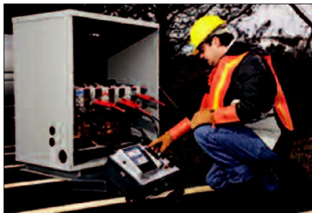
TTR330 в процессе тестирования трехфазного трансформатора, установленного на бетонной плите
